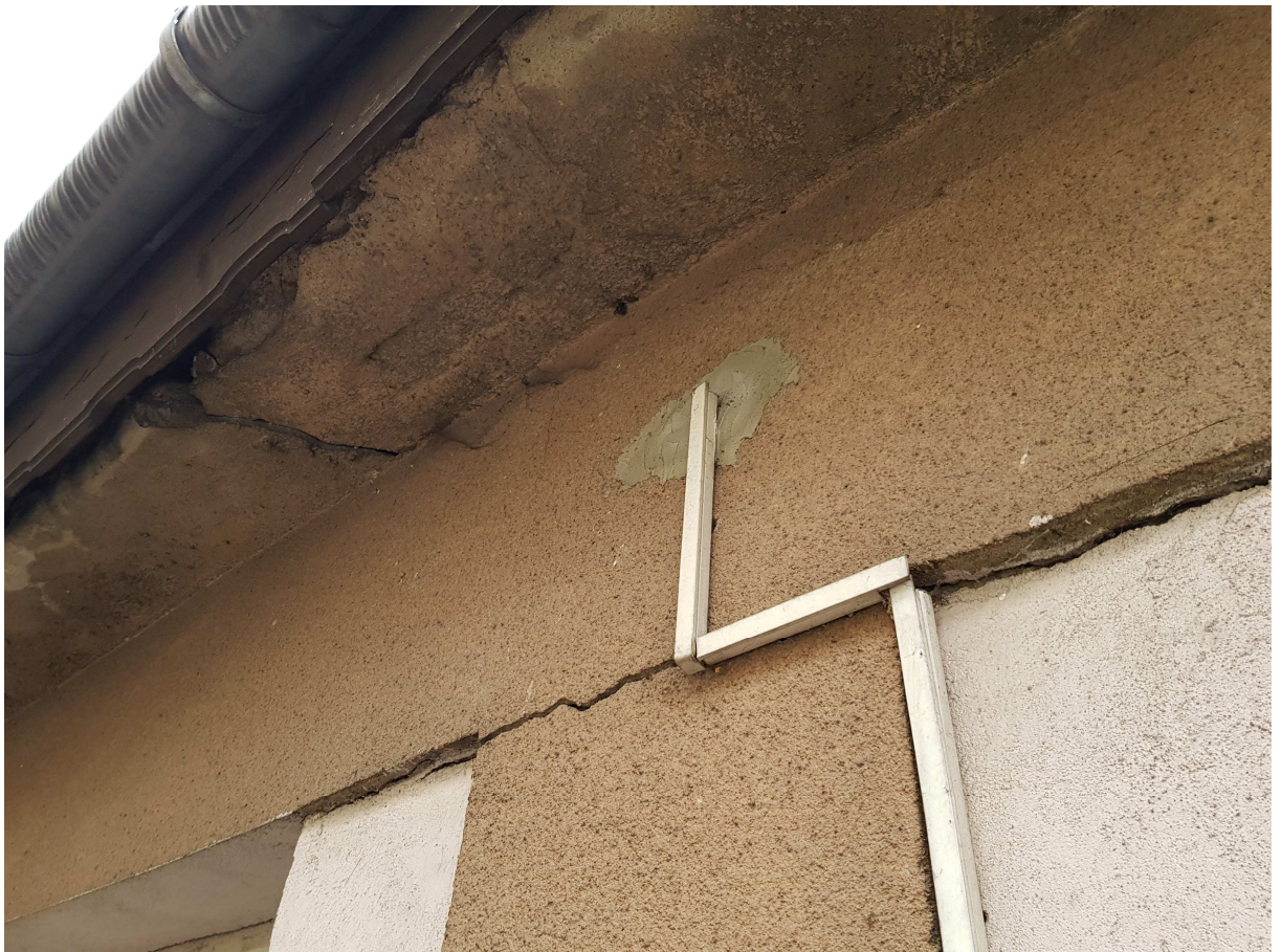
Zał. 10. Widoczne spękania
