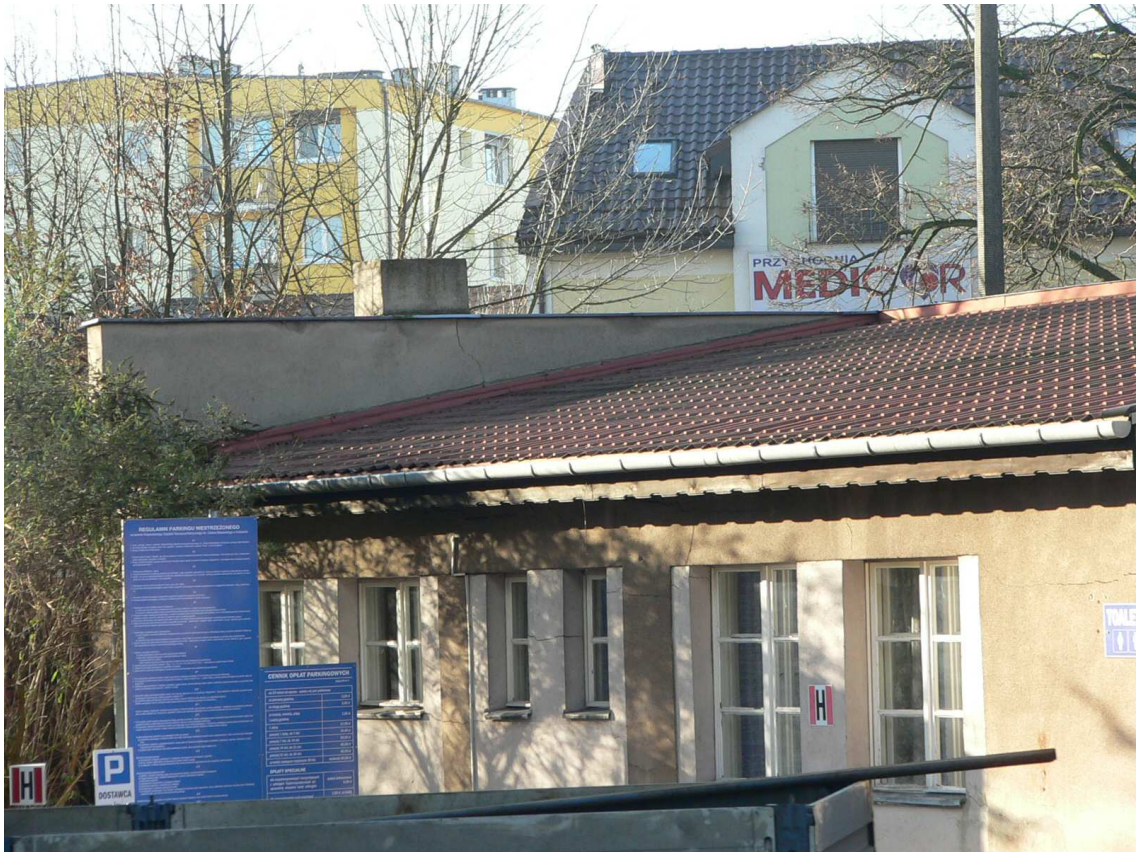
Zał. 9. Widoczne spękania
