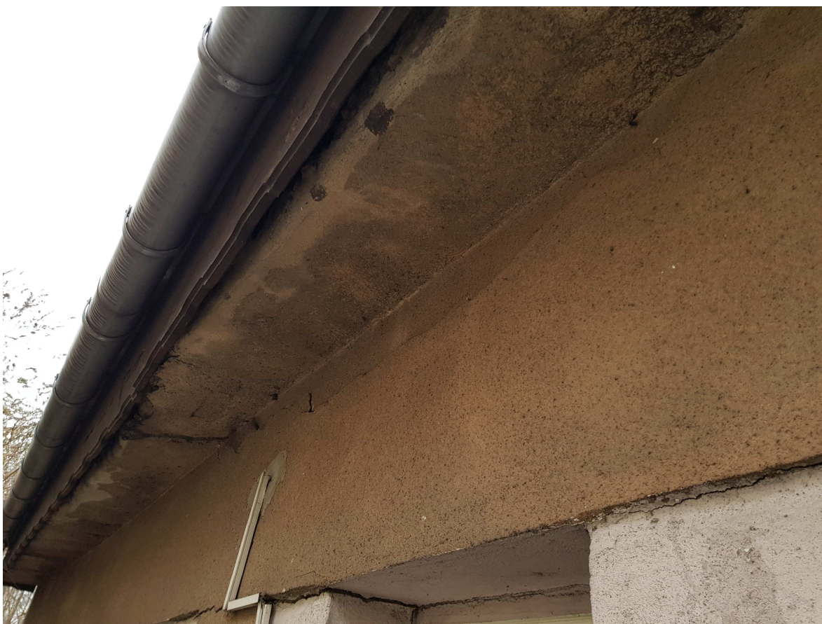
Załącznik 12. Widoczne spękania
