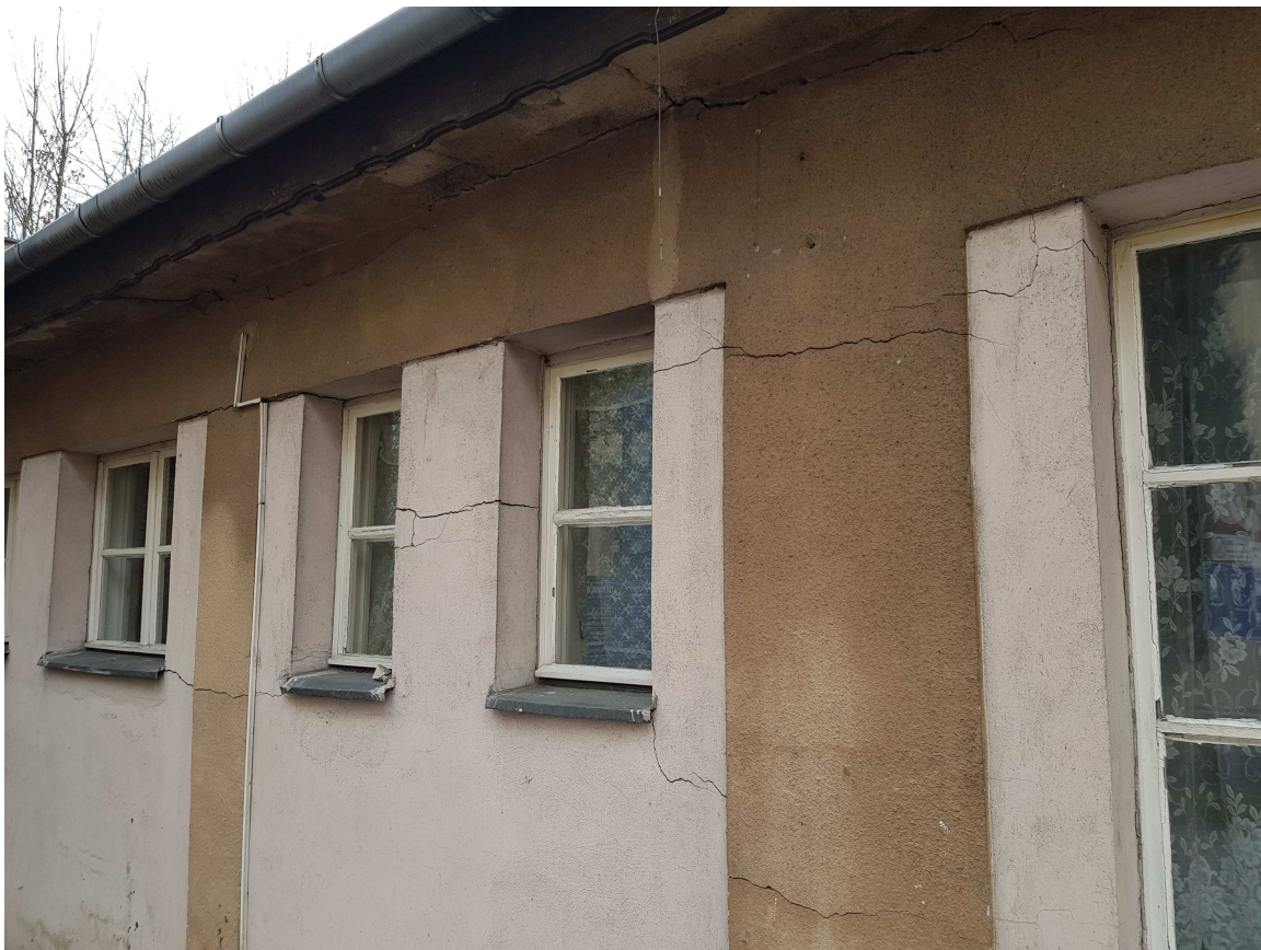
Załącznik 11. Widoczne spękania
