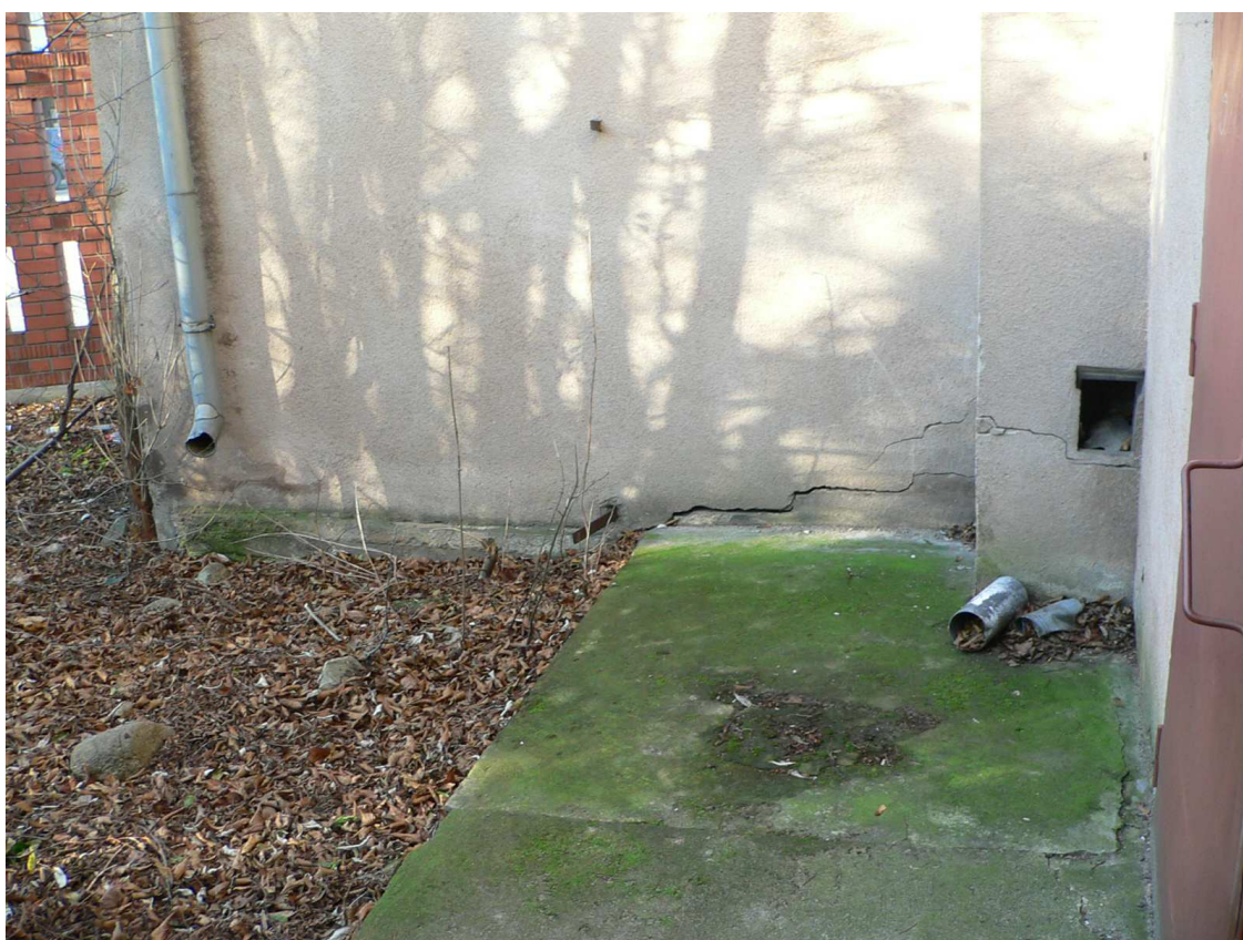
Załącznik 8. Widoczne spękania
